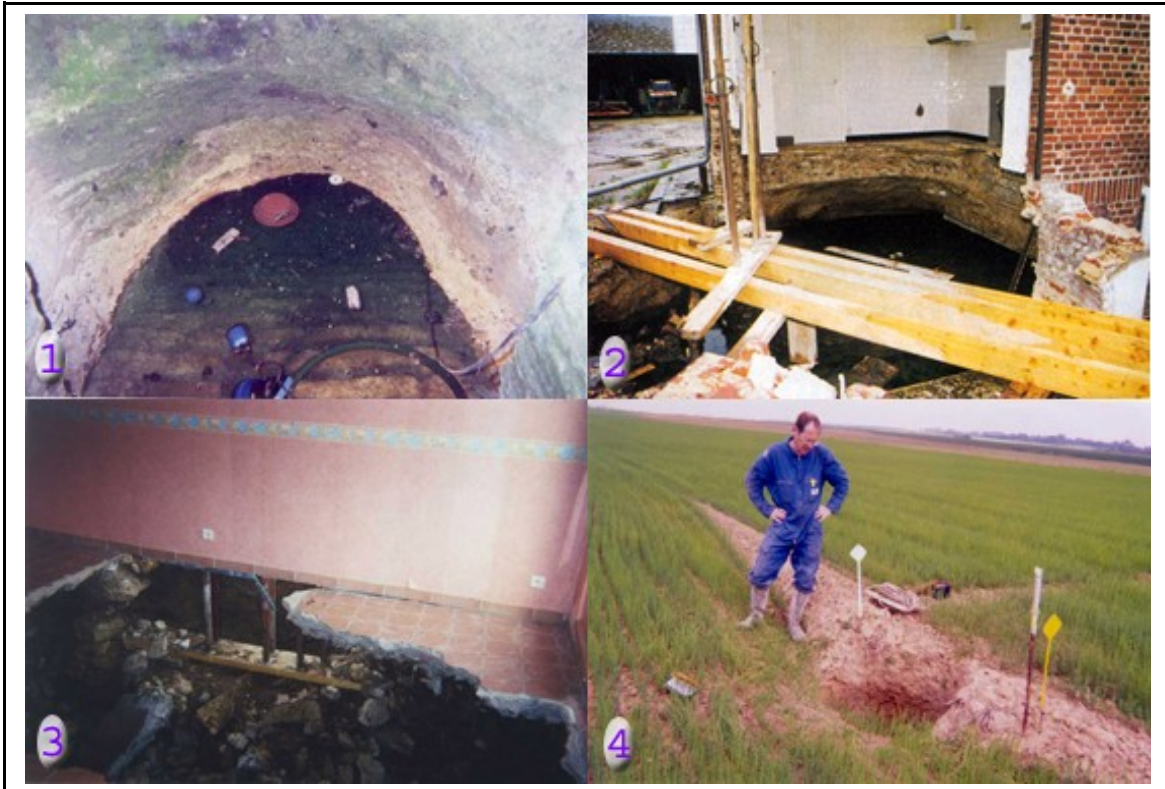
Fig.3 : 1 : Situation en avril 2002 d'une cave – 2 et 3 : Effondrements du sous-bassement des habitations dans la commune voisine de Tricot – 4 : Débouillage d'une marnière dans un champ
