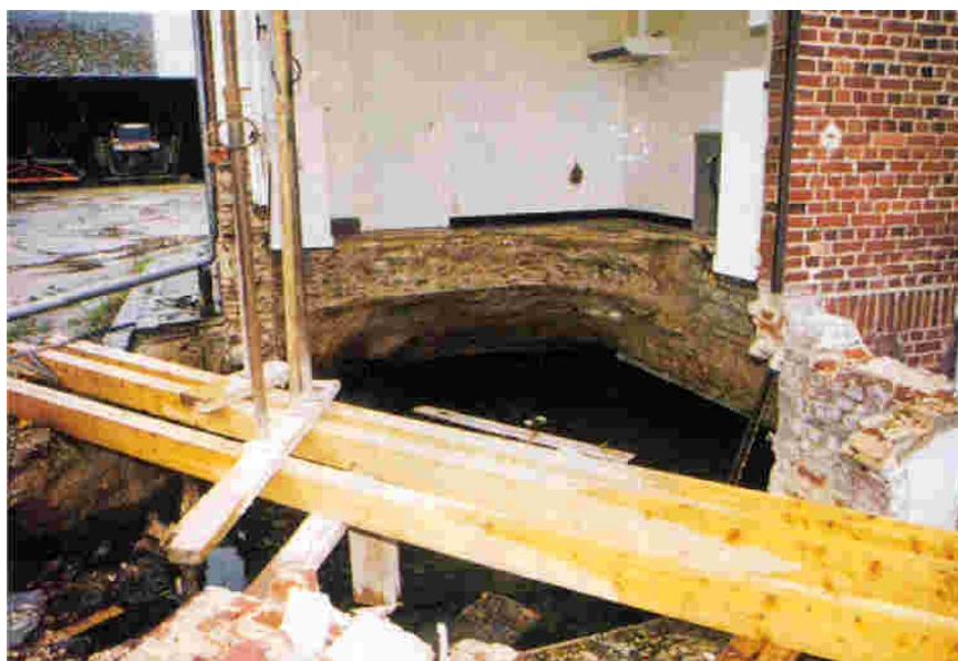
Fig.6 : Effondrement d'une cavité sous une structure de surface dans la commune voisine de Tricot
